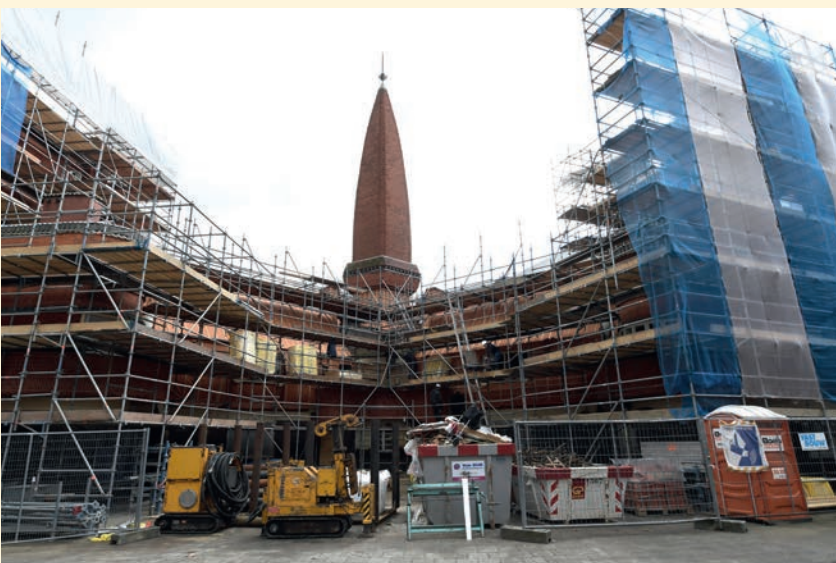
▲ De 82 huurwoningen in Het Schip worden van binnen en buiten grondig gerenoveerd en gerestaureerd.
