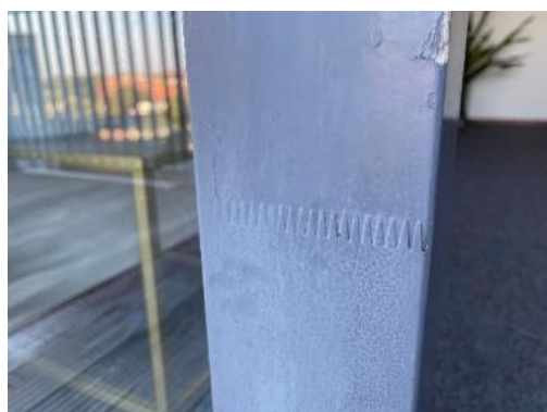
Defecten op vingerlas
